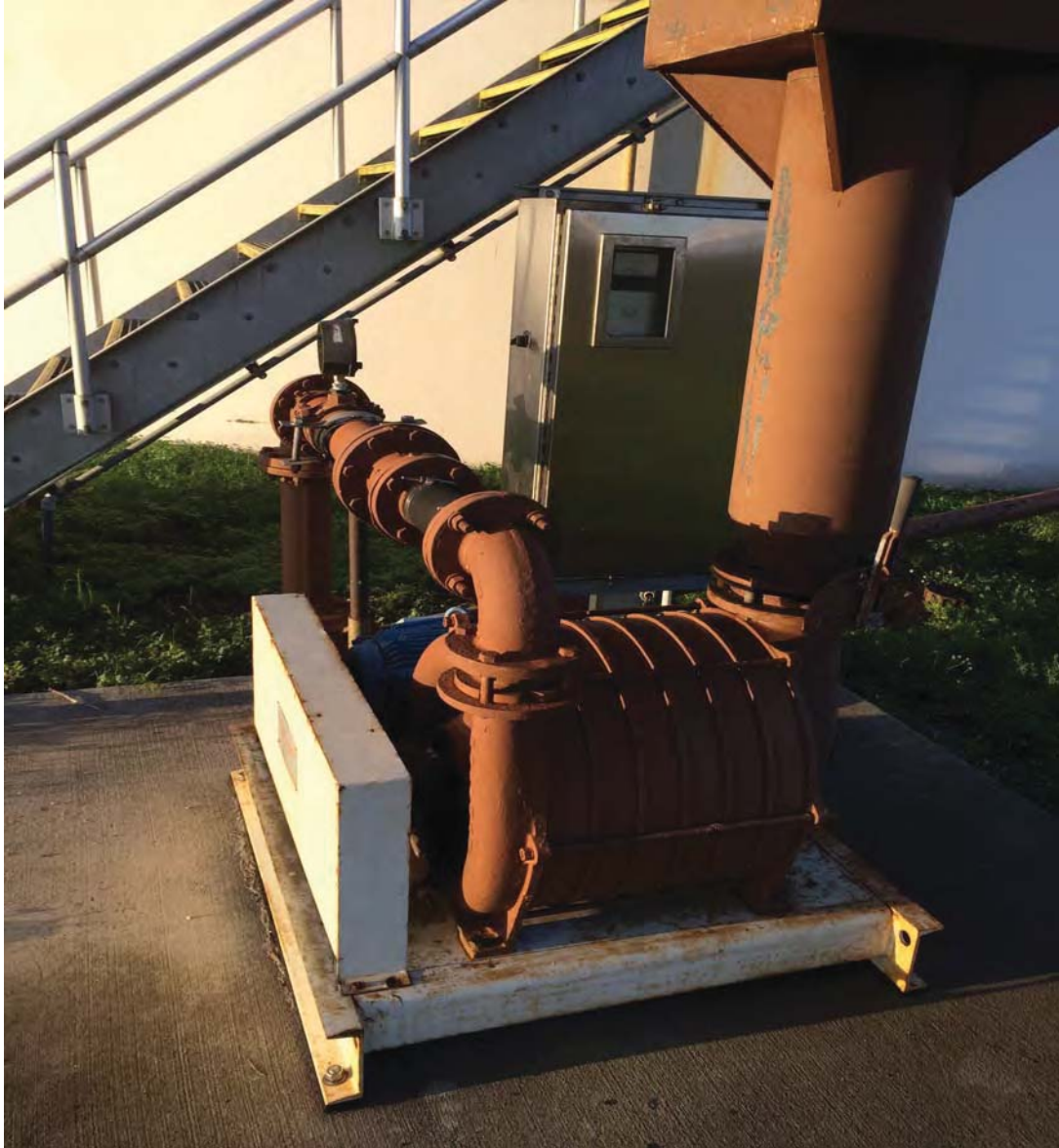
WWTP DSSU MOTOR / BLOWER
