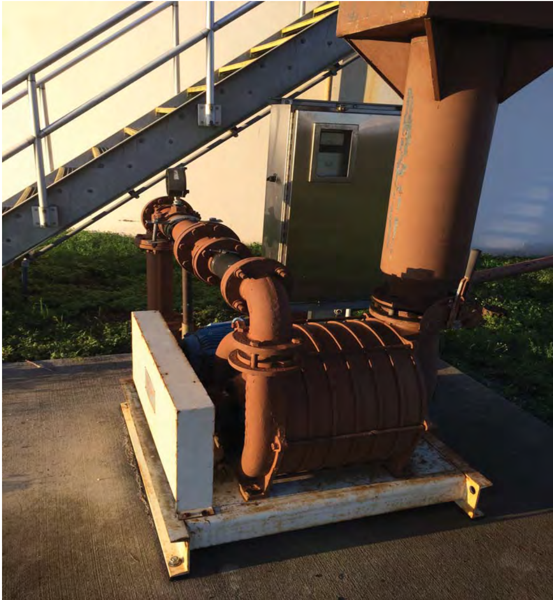
WWTP DSSU MOTOR / BLOWER
