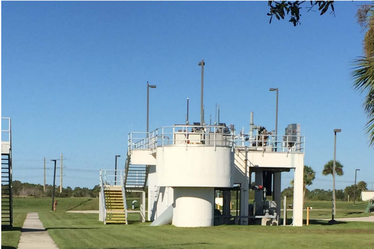
Figure 5-3 Punta Gorda WWTP – Headworks
